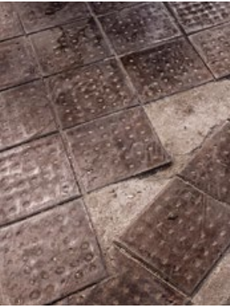
ЧУГУННЫЕ ПЛИТЫ (ДО ВОССТАНОВЛЕНИЯ)
